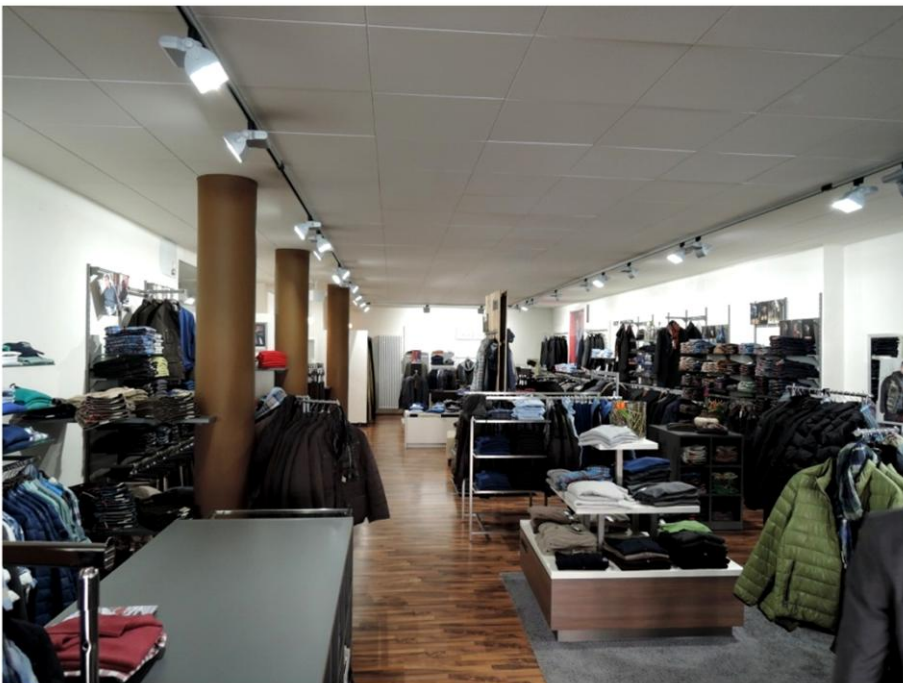
Beleuchtung eines Textilien-Verkaufsbereichs mit YES-3-Phasen-Strahlern
