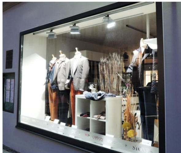
Schaufensterbeleuchtung mit YES-3-Phasen-Strahlern
