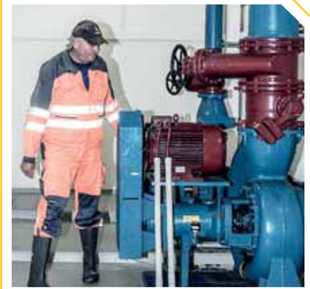
Herbert Hauser im unterirdischen Abwasserpumpwerk Neugablonz
